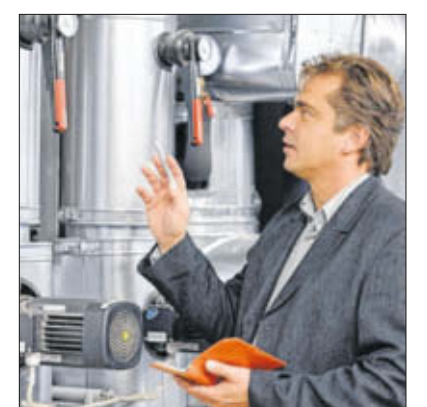
An der Heizung des a-ja-Resorts Warnemünde: Michael Donath (43).
